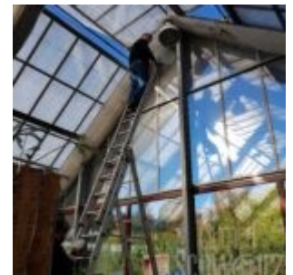
Leuchtmittelaustausch von 250W Metaldampflampen auf 40W LED
