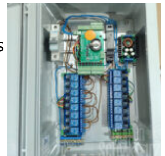
Klimacomputer für 2 Gewächshäuser vor dem Einbau.
